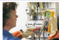
Проверка изоляции в распределительном щите
