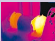
Перегрев крышки подшипника
