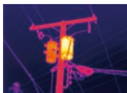
Перегретый полюс трансформатора
